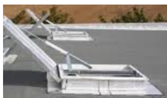
Extraction naturelle en partie haute
