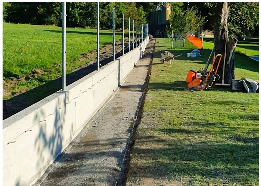
Chablais vaudois, muret de protection contre le ruissellement, © Fonds EN
