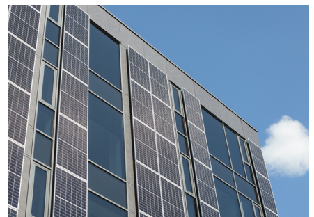
Des panneaux solaires posés en façade
